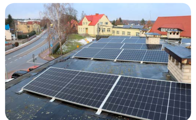
➤ Panele fotowoltaiczne zainstalowano na 27 budynkach użyteczności publicznej
