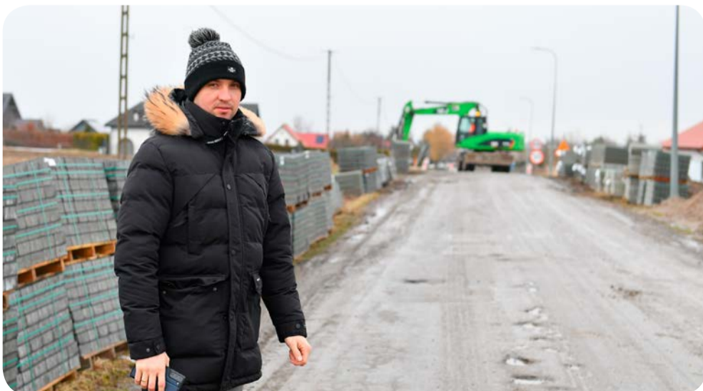
↑ Postępy prac na budowie drogi Różyny – Żeliszawki na bieżąco śledzi radny Jarosław Juchniewicz
