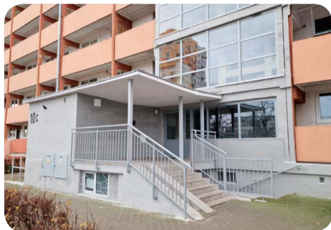
↗ Remontowane są wejścia i partery klatek schodowych w faldowcu przy Obrońców Wybrzeża
