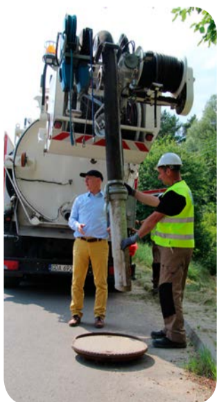
Prezentacja samochodu do prac związanych z czyszczeniem i eksploatacją sieci obiektów kanalizacji deszczowej
